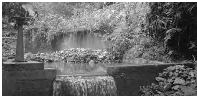
Foto N° 19. Acueducto comunitario El Socorro, Envigado, Antioquia.
