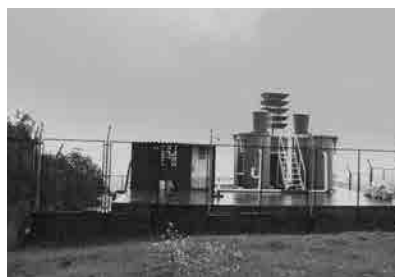
Foto N° 18. Acueducto comunitario Acuatcat, Mochuelo Bajo, Ciudad Bolívar, Bogotá.
