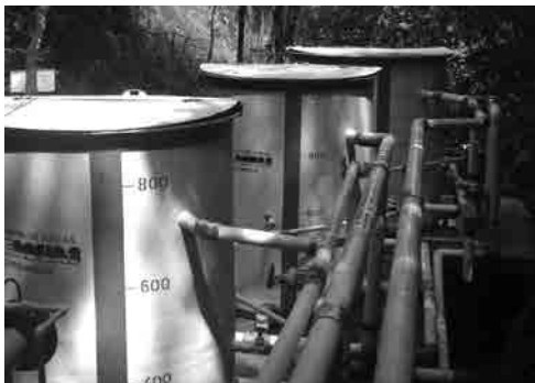
Foto N° 8. Tratamiento de agua, – Acueducto El Socorro, Envigado Antioquia.
