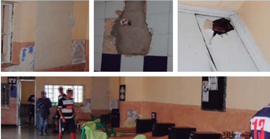
Imagen 8: Bogotá. CAE El Redentor. Congregación Religiosa Padres Terciarios Capuchinos. Vista de estado de locaciones al momento de la visita. Se requieren reparaciones.
