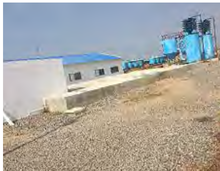
Foto 5. Sistema de tratamiento.
