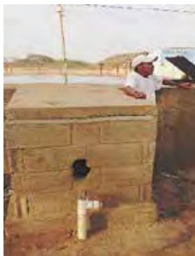
Foto 29. Tanque de Almacenamiento.
