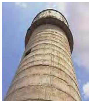
Foto 13. Tanque de almacenamiento.
