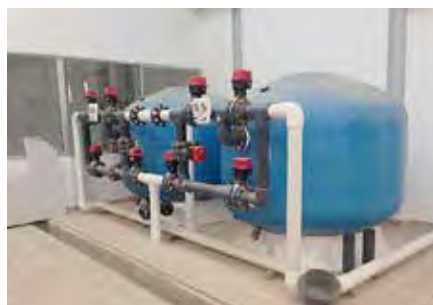
Foto 18. Zona de tratamiento desalinizador.
