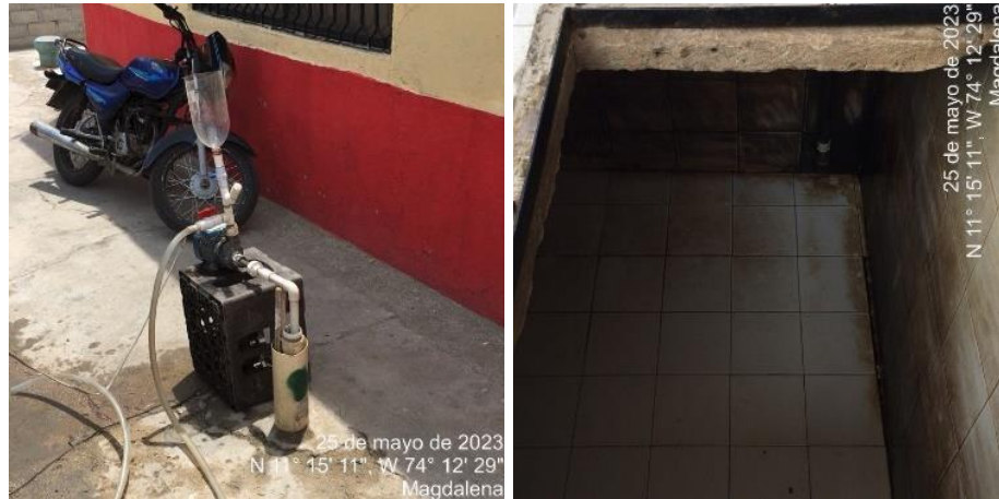
Fotos 1 y 2. Sistema de bombeo pozo profundo y tanque de almacenamiento agua potable vivienda líder comunitario sector Pescaito Fuente. Defensoría del Pueblo, mayo 2023
