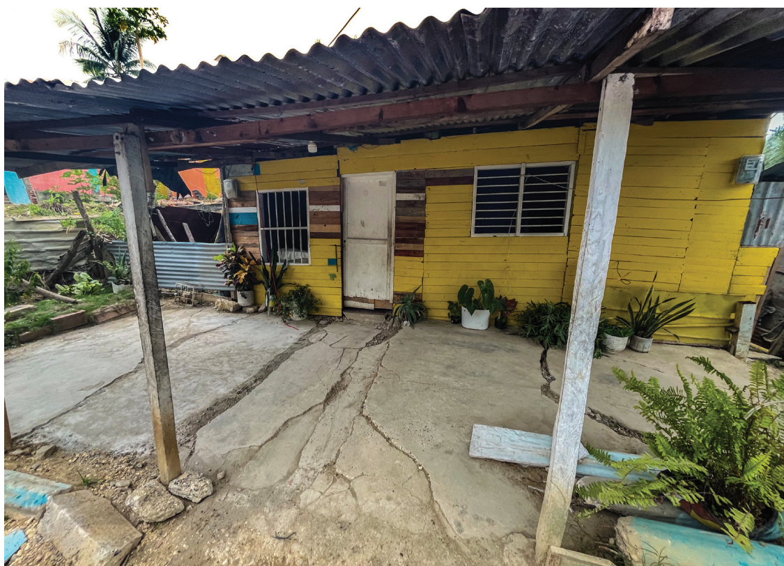
Figura 4. Afectaciones estructurales a vivienda sector Jardines
